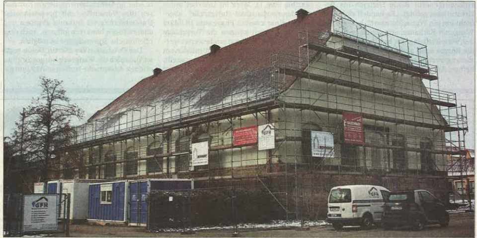
Der Umbau der alten Reithalle ist bereits im Gang. Zurzeit wird das Innere entkernt.
