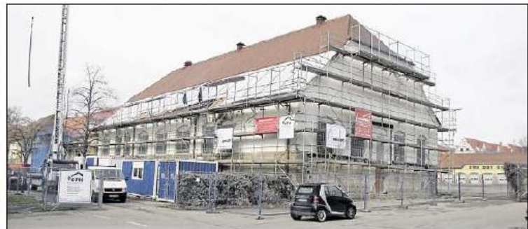
Das Gebäude für die Schulnutzung wird derzeit bereits saniert. Dort sollen Räumlichkeiten zur Nutzung für die Steig- und die Altenburgschule entstehen.
